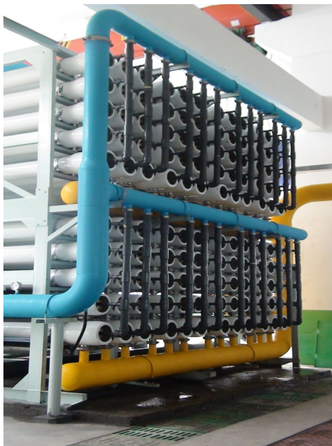
图 1.7.3 舟山六横万吨级国产海水膜元件应用示范装置
