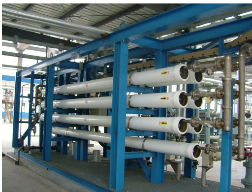
图 3.2.2 纳滤膜法脱除硫酸根离子装置
