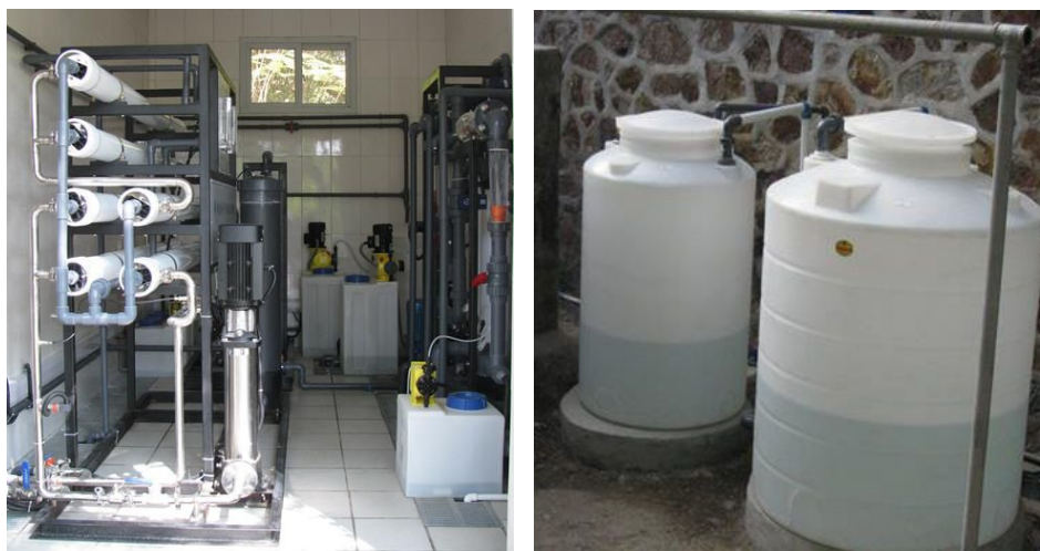
图 1.3.1 东瑁洲岛 100m³/d 苦咸水淡化工程
