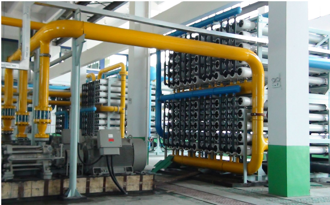
图 1.1.2 舟山六横水务公司一期 20000m 3 /d 反渗透海水淡化装置
