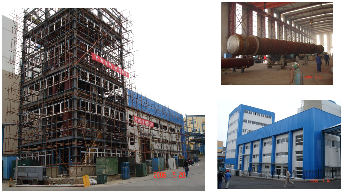
图 2.6.12 500 m 3 /d 低温多效蒸发海水淡化示范工程
