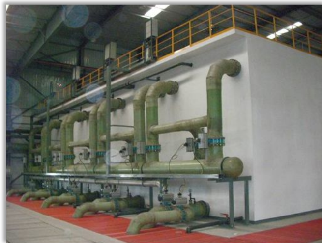
图 1.16.2 曹妃甸 50000 m 3 /d 淡化水后矿化处理主体设备
