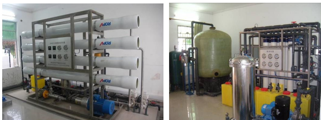
图 1.3.4 永兴岛 100m 3 /d 海水淡化工程
