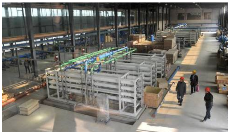
图 3.4.6 大丰市非并网风电日产万吨淡化海水示范项目生产车间
