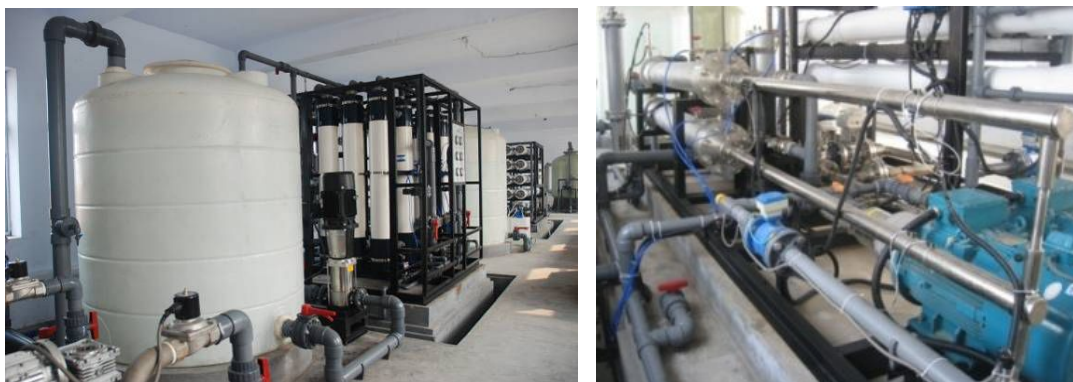
图 1.3.3 灵山岛 300m 3 /d 海水淡化示范工程
