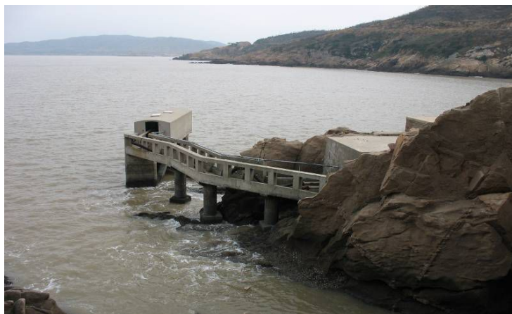
图 1.2.4 嵊泗淡化厂海水取水系统
