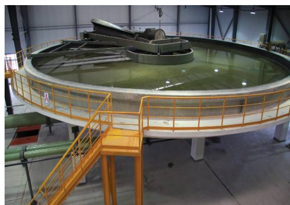
图 1.1.5 海水预处理气浮装置
