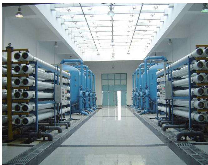
图 1.2.5 嵊泗千吨级海水淡化工程反渗透装置
